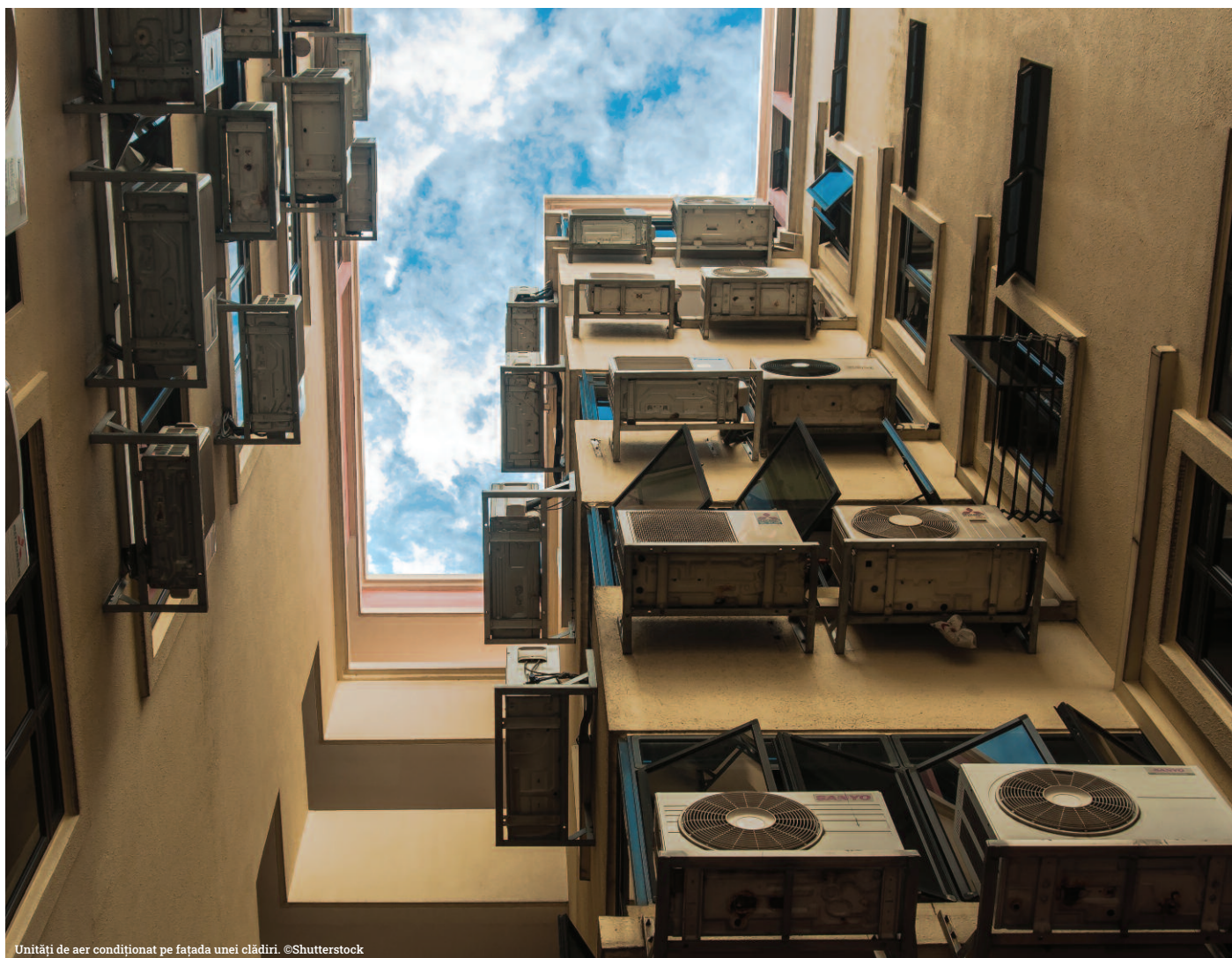
Unități de aer condiționat pe fațada unei clădiri. ©Shutterstock
