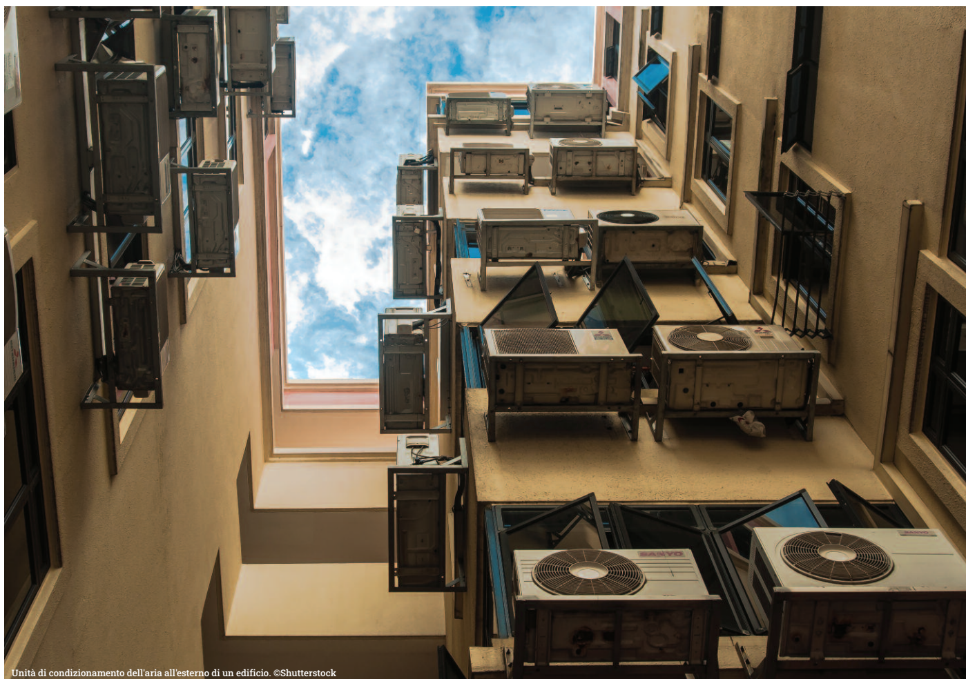
Unità di condizionamento dell'aria all'esterno di un edificio. ©Shutterstock
