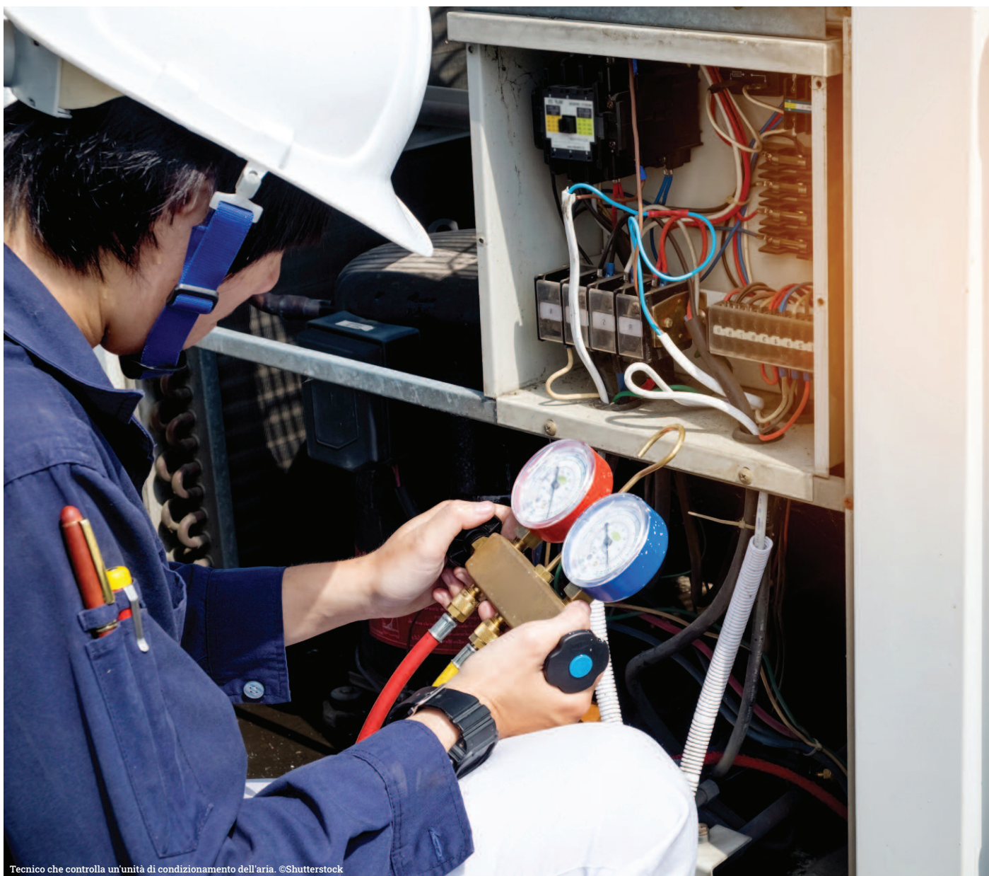
Tecnico che controlla un'unità di condizionamento dell'aria. ©Shutterstock
