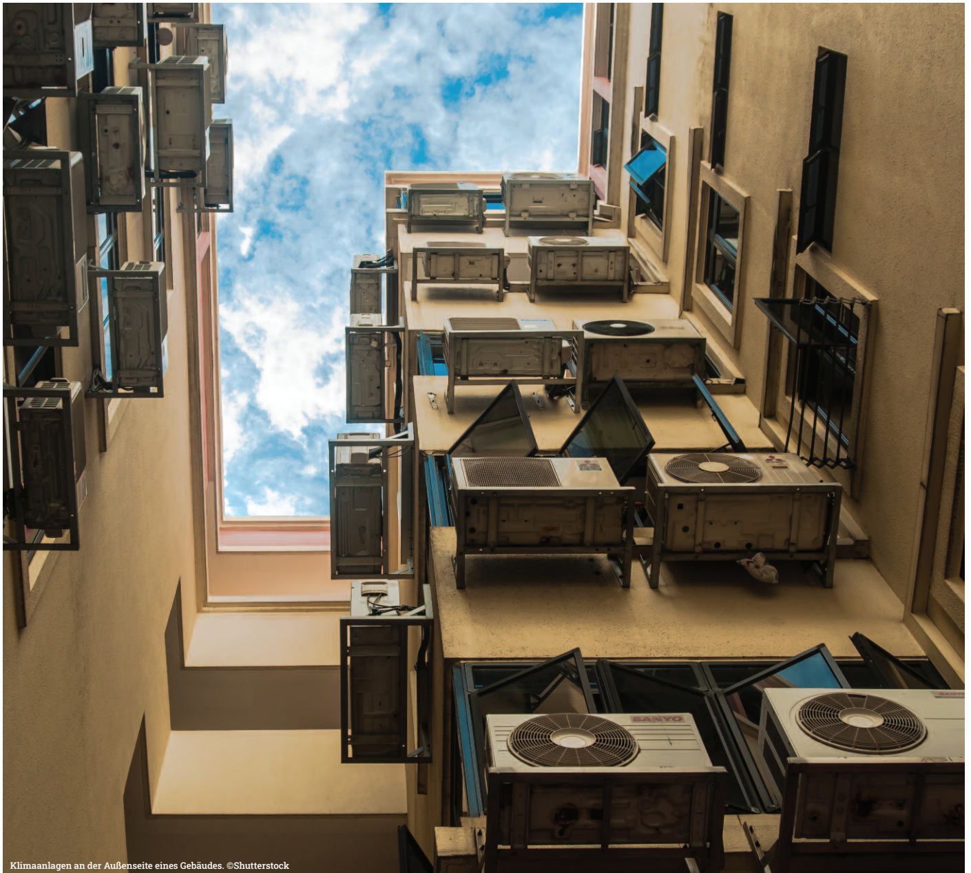
Klimaanlagen an der Außenseite eines Gebäudes. ©Shutterstock
